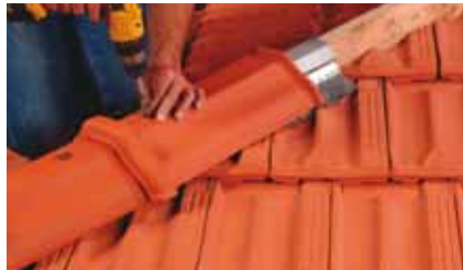
Après coupe des tuiles d'approche, pose du closoir ventilé sur lisse de rehausse et fixation des arêtiers par vis et rondelle d'étanchéité.
